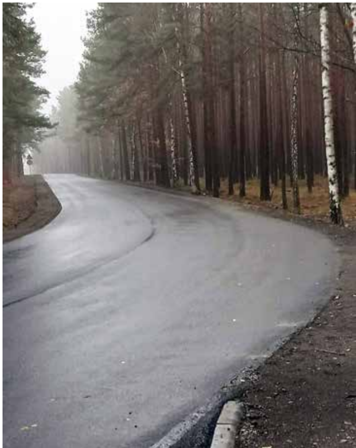
Przebudowa drogi powiatowej nr 1144F na odcinku od drogi krajowej nr 32 do drogi wojewódzkiej nr 279 w miejscowości Drzonów – etap II. Całkowita wartość zadania - 2 732 457 zł. Inwestycja zrealizowana przy wsparciu finansowym Lasów Państwowych - 2 242 000 zł, Gminy Świdnica - 250 000 zł oraz Powiatu Zielonogórskiego - 250 000 zł.
